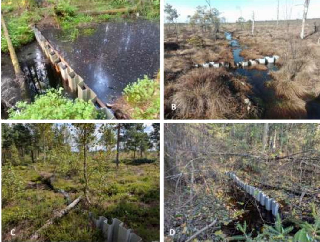
41 pav. Funkcionuojančių (A, B) ir deformuotų ar netinkamai įrengtų pertvarų iš plastikinių sprausasienių pavyzdžiai Aukštajojo Tyro pelkėje
