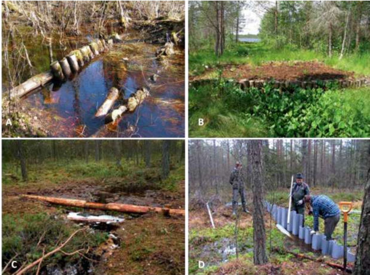
55 pav. Užtvankų tipai Pajūrio kanale: polinė–durpinė (A – išplauta, B – sulaikanti vandenį), rąstinė su geomembrana (C), polichlorvinilinių spraustlenčių (D) užtvanka.
