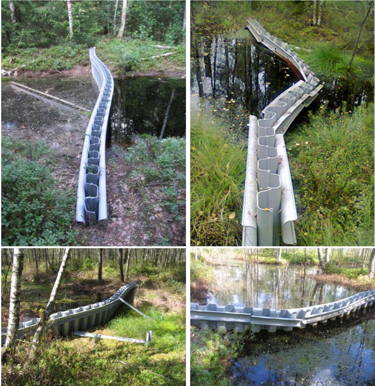
47 pav. Užtvankų iš plastikinių spraustasienių deformacijos ir pažaidos Balandinės pelkėje 2014 m.
